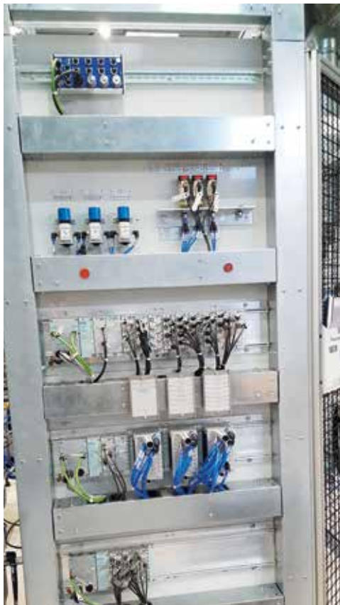
>> Installationsbeispiel einer Messanlage
